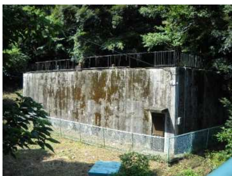
(田子低区配水池)
