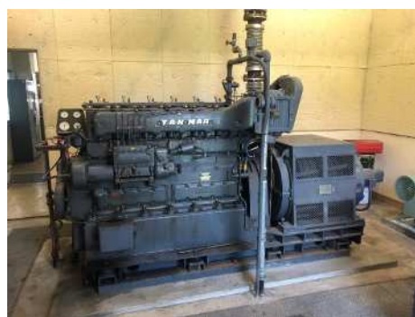
(先川浄水場非常用自家発電機)
