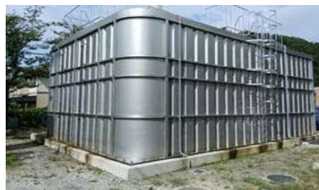
先川浄水場浄水池 (377m 3 )
