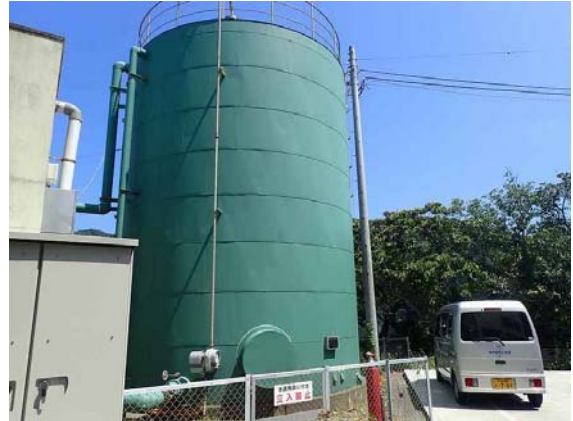
堂ヶ島主配湯所貯湯槽
