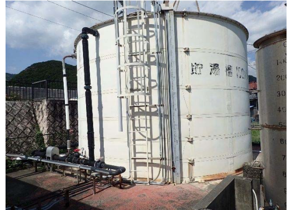
宇久須貯湯槽
