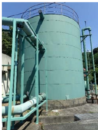
堂ヶ島副配湯所貯湯槽
