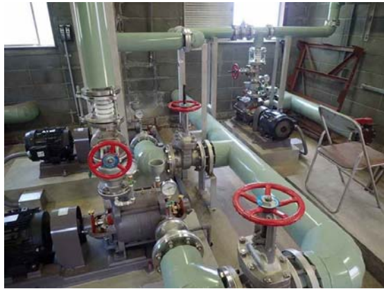
堂ヶ島主配湯所送湯ポンプ
