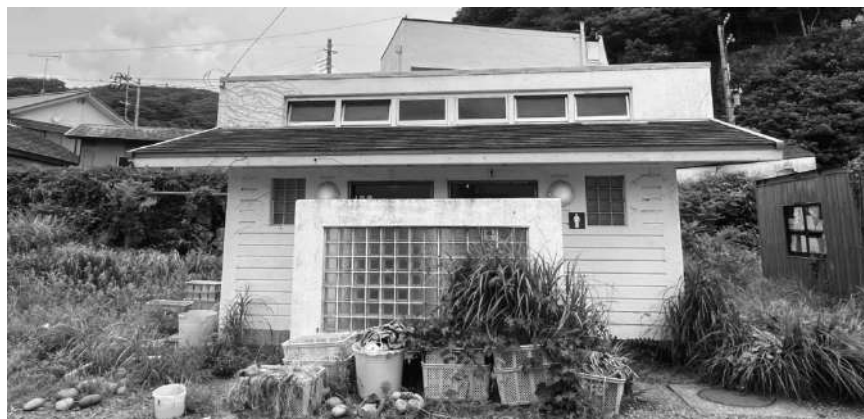
老朽化した仁科漁港公衆トイレ
