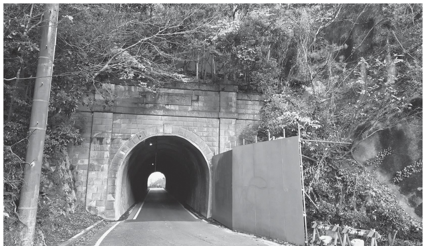
現在は落石防止用に仮設のコンパネが設置されています
