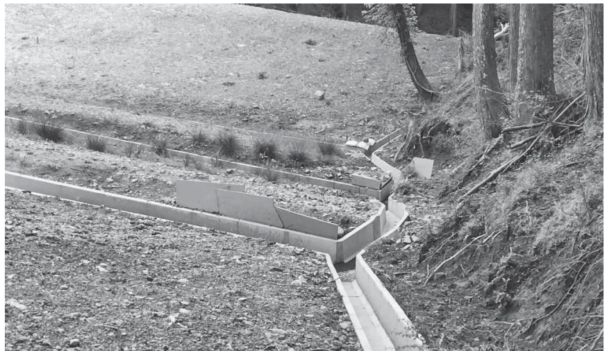
さらなる改善対策が求められる排水路合流地点
